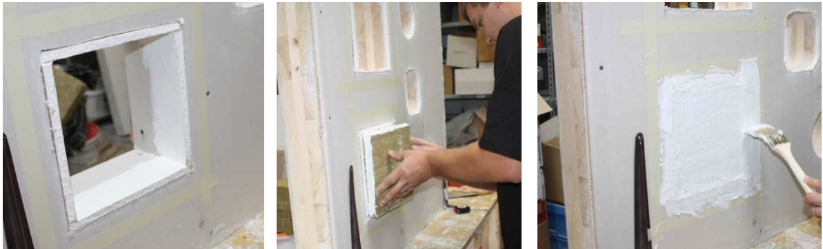
Abbildung 83: Einbau des Weichschotts in einen Probekörper (links: Leibungsverkleidung Mitte: Einbau der an den Kanten beschichteten Mineralfaserplatte, rechts: Überbeschichtung der Oberfläche über den Rand von 20 mm)
