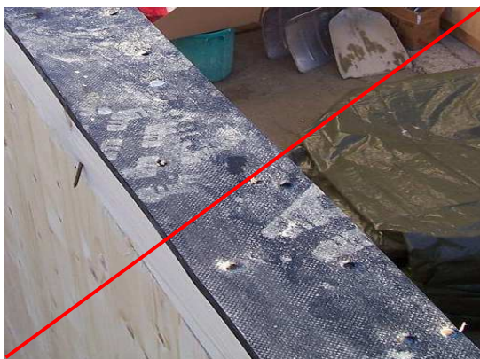
Abbildung 65: Unzulässige Befestigung des elastischen Lagers mit Nägeln
