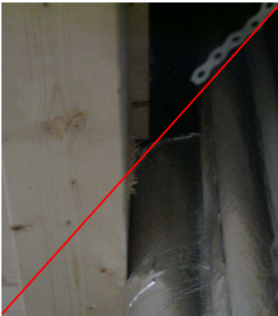
Abbildung 79: fehlerhafte Ausführung: Aufgrund einer nachträglichen Vergrößerung des Schachtes ist schachtinnenseitig keine nichtbrennbare Bekleidung des hölzernen Unterzuges möglich.
