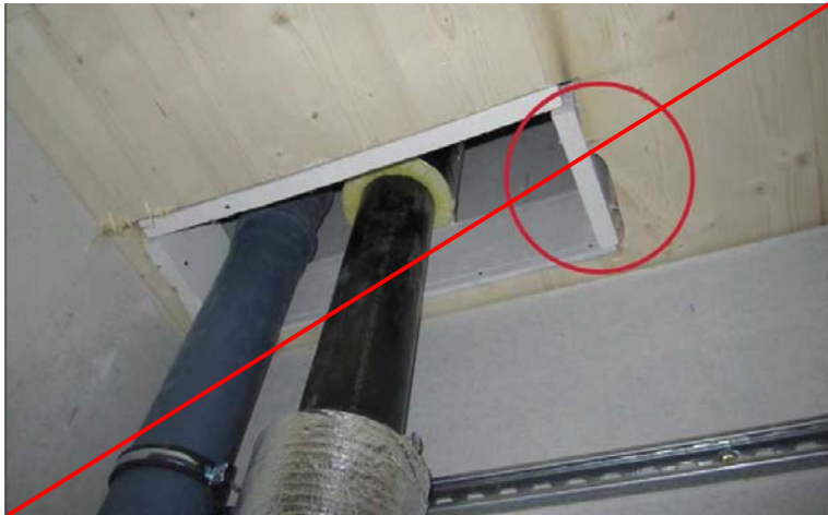
Abbildung 80: fehlerhafte Ausführung: Nicht vollflächiger Einbau der Leibungsverkleidung
