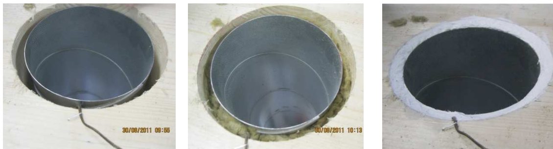
Abbildung 90: Dämmung des Ringspalt zwischen Lüftungsrohr und Holzbauteil mit Steinwolle (Mitte), Anbringen einer intumeszierenden Brandschutzmasse mit einer Tiefe von ca. 15 mm (rechts)
